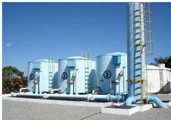
Figura 7.2 - Estação de Tratamento de Água da Sede de Aquiraz
