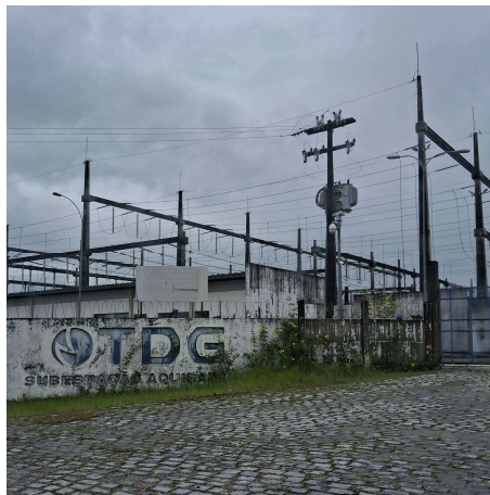
Figura 7.17 - Subestação de Aquiraz (Sede)
